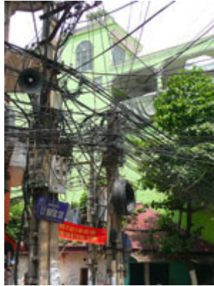
Hilarante cableado telefónico.
